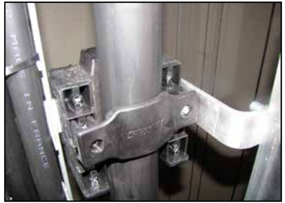
Manglende fastgørelse af kabel i tårn.
